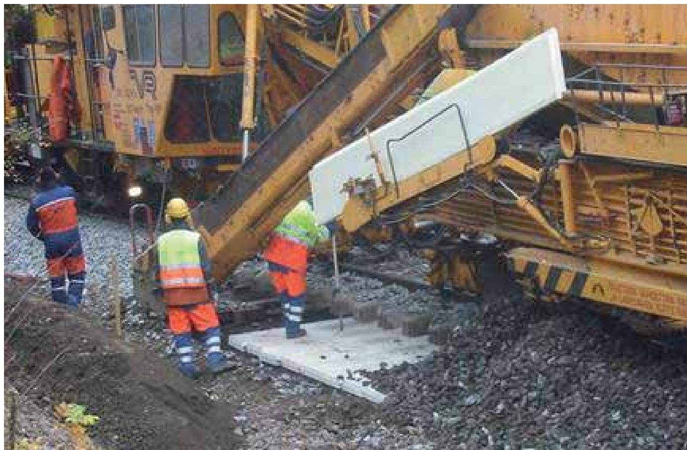
Tack vare den höga hållfastheten och den låga vattenupptagningen används Finnfoam som tjälskydd för järnvägar. Se bild ovan.
