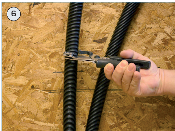
6 Kapa skyddsroret för matningsledningen.
